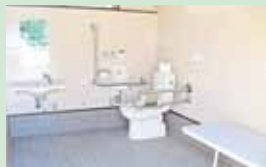
ユニバーサルシートのある 車いすトイレ兼更衣室 鳥羽市宮安楽島(あらしま)海水浴場
